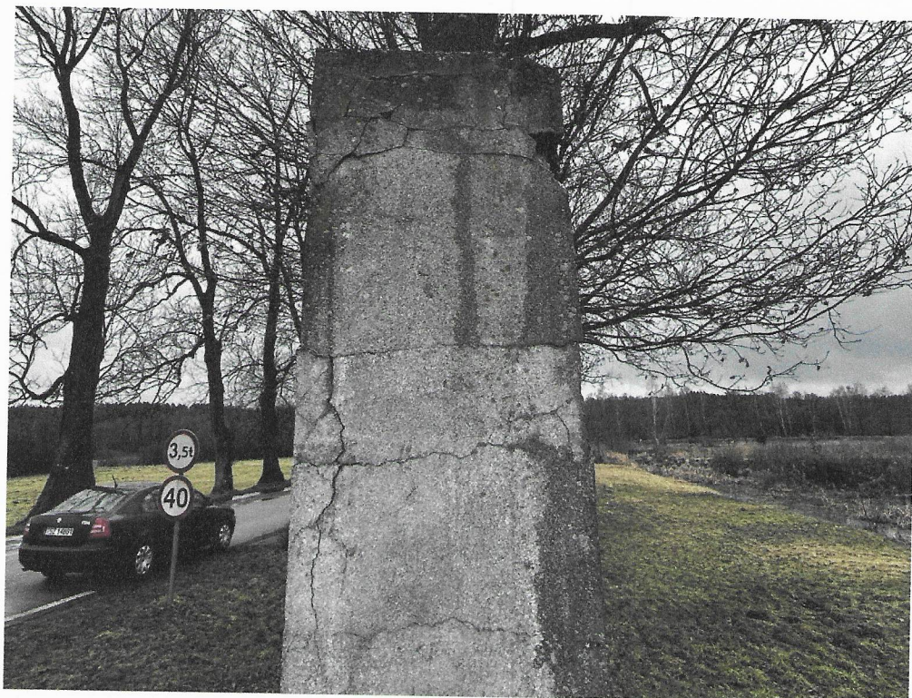
Fot. nr 4 Pomnik Pamięci Piłsudczykom z 1931 roku w Niekrasowie. Widok charakterystycznych spękań warstwy lastriko
